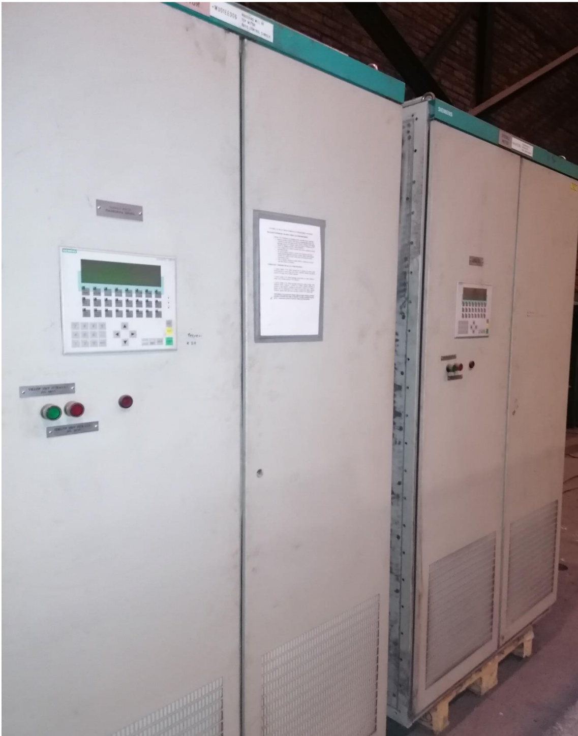
Slika 1 - Zunanji izgled omar od regeulatorjev za ZGORNJI in SPODNJI pogonski motor
